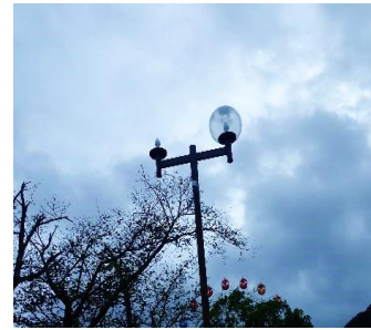
駐車場照明器具破損
