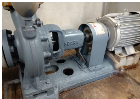
ろ過ポンプ稼働状況
