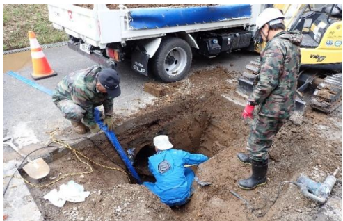
漏水箇所確認
