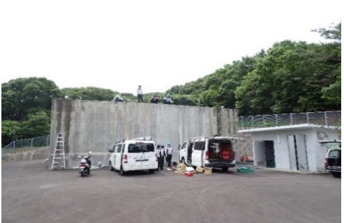
井水貯水槽外観
